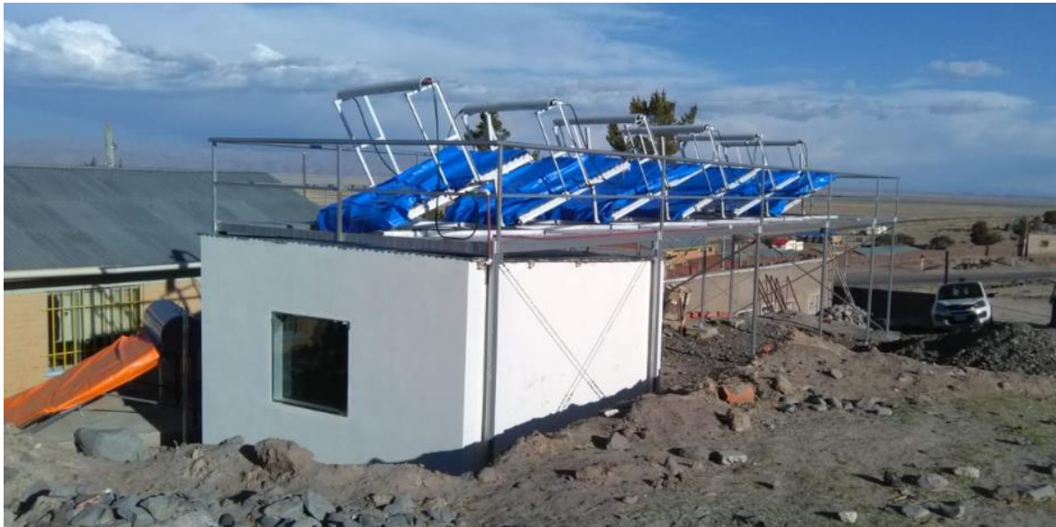
Figura 6: Foto-reactor solar UVA y sistema de tratamiento de aguas con As instalado en Quillacas – Oruro, Bolivia.
